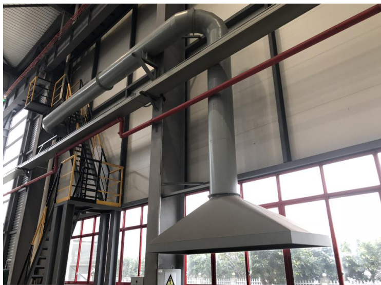
废气集气收集装置
